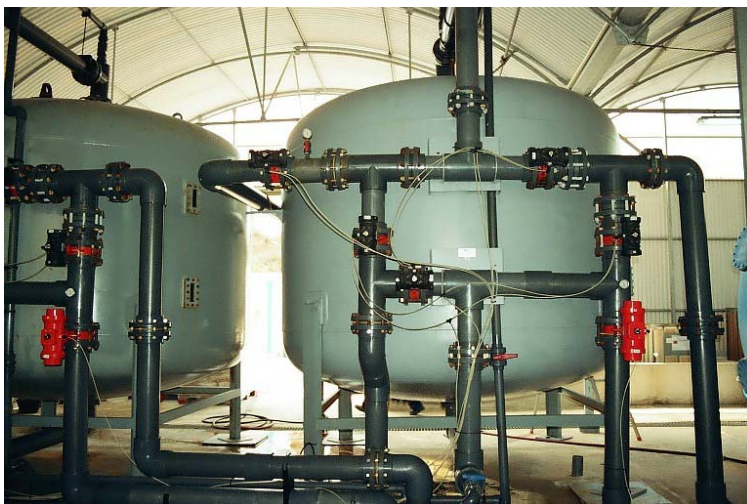
Filtros de arena
